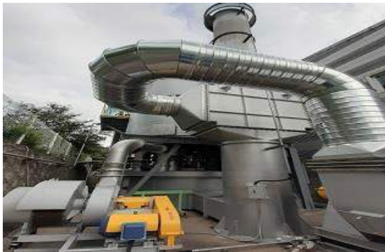
▲ 환경오염 방지시설 설치
